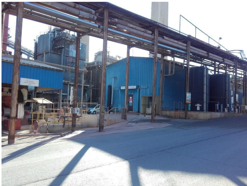
Photo 2 : Station de production d'eau déminéralisée existante
