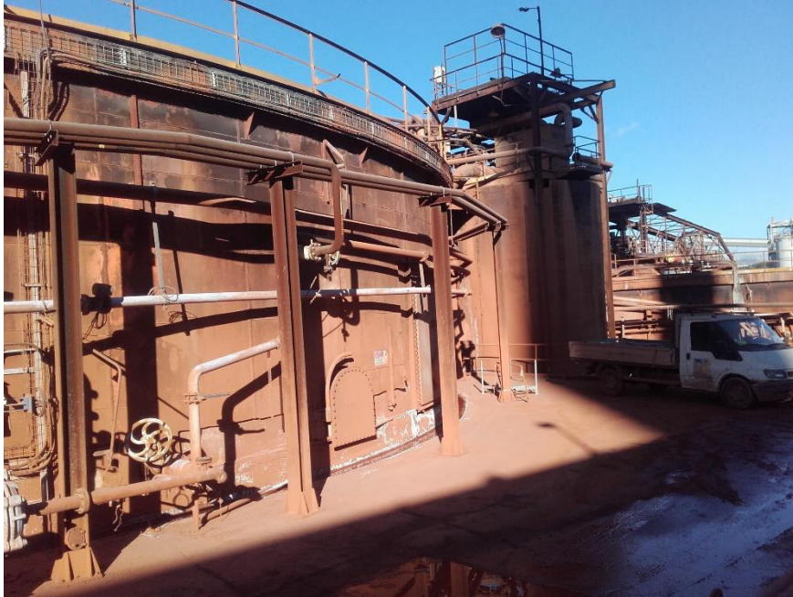
Photo 3 : Décanteur-laveur 471 de récupération des effluents
